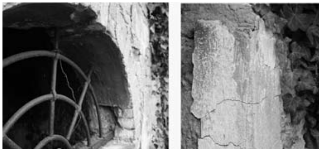
Fig. 9. Particolari della finestra (a sinistra nella foto) e dello stipite della porta (a destra) presenti negli attuali resti dell'oratorio di S. Maria delle Calegare (foto Mauro Filippini).
